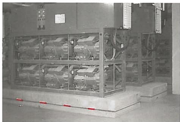
Centrale de climatisation
